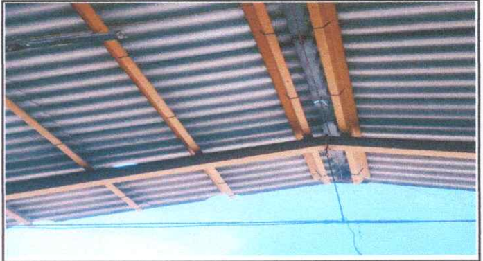
Foto 4: Se puede observar de como se encuentra la lamina fibrocemento en el modulo a trabajar.
