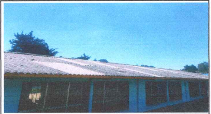
Foto 2: Se puede observar de como se encuentra la lamina fibrocemento en el modulo a trabajar.
